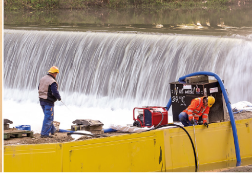
↑ Fischtreppe – Wehr Hammer, Fischaufstieg
